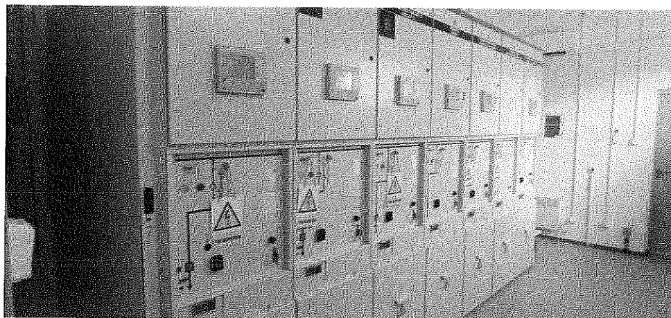
Rozdzielnia wewnętrzna 30 kV
