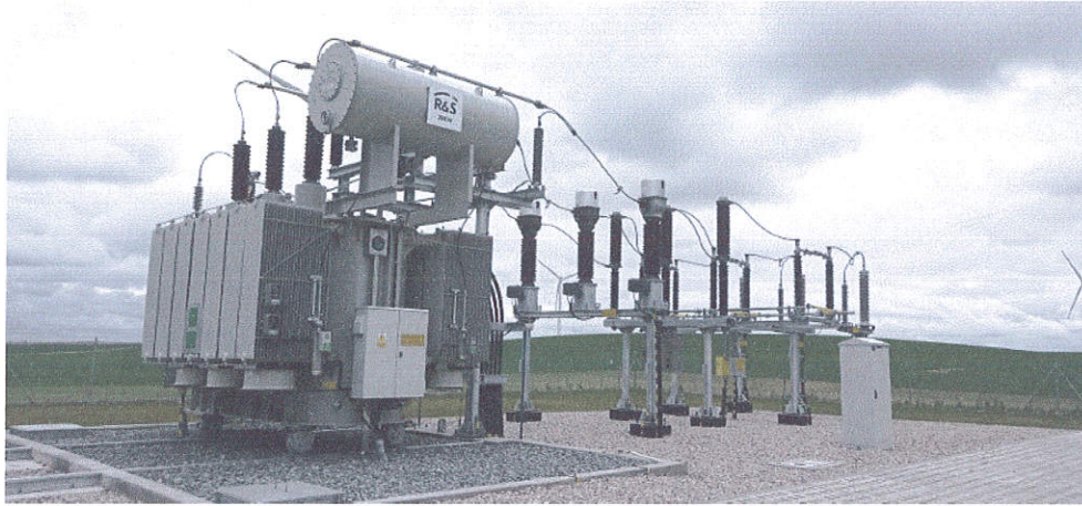
Rozdzielnia napowietrzna 110 kV
